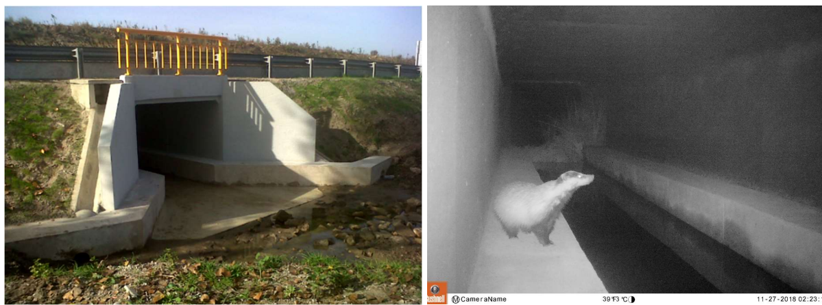
Fig. 37 – PH na EN18, ao km 274,800, com dois passadiços secos. Na fotografia da direita é possível visualizar um texugo a utilizar um dos passadiços (fotografia captada pela Universidade de Évora durante a monitorização da PH).
