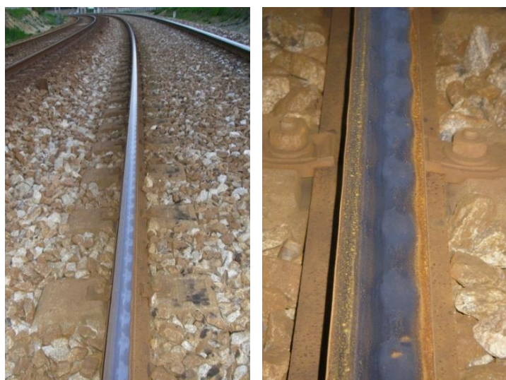
Figura 18. Descasque e desgaste ondulatorio em carril (Linha de Cascais).
