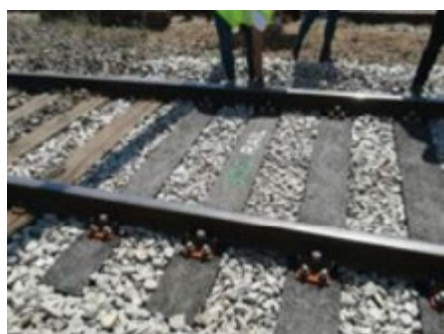
1.ª instalação concluída, numa linha de acesso à triagem, no Entroncamento
