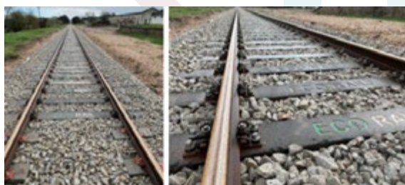
Conclusão da empreitada em final de novembro de 2020 - Troço de instalação das travessas Eco Rail, na Linha do Leste.
