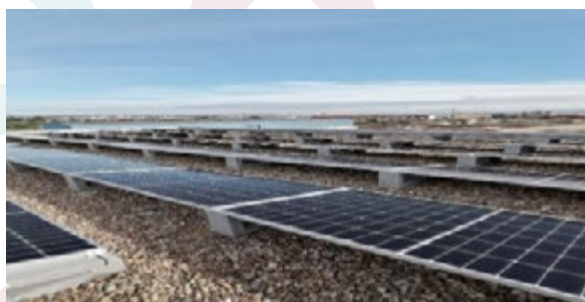
Central solar para autoconsumo instalada no Complexo Logístico do Entroncamento.
